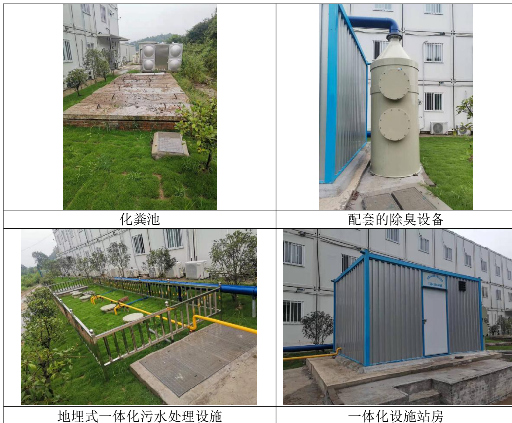
图 4-3 一体化污水处理设施现状图
