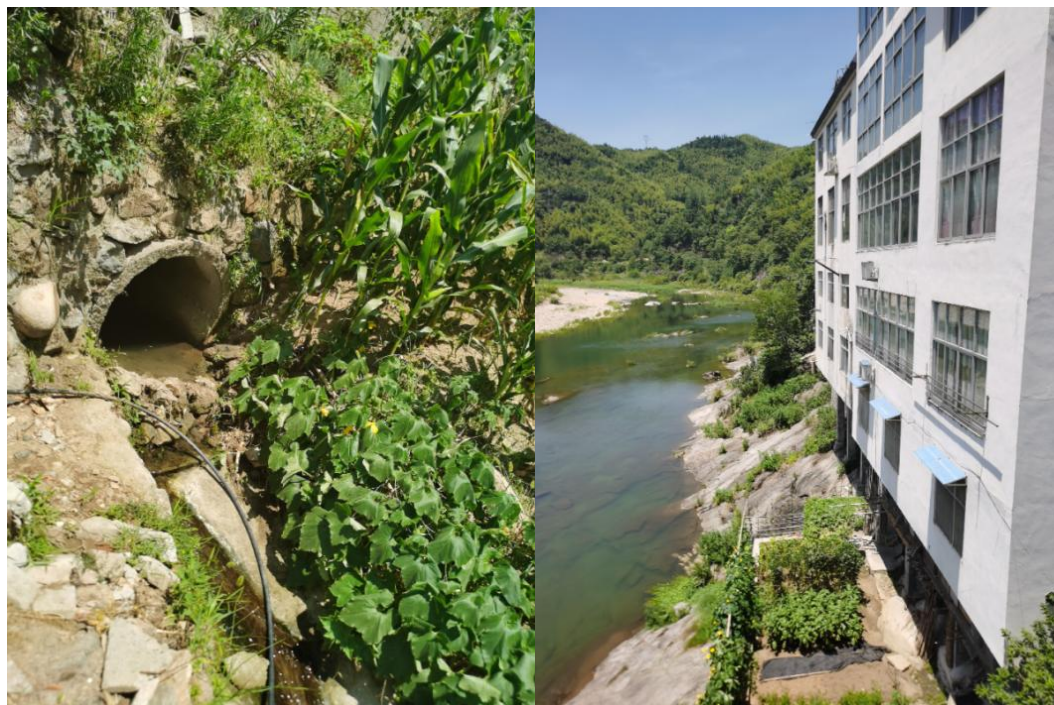
图 3.6-3 污水散排、厨房污水散排入河
