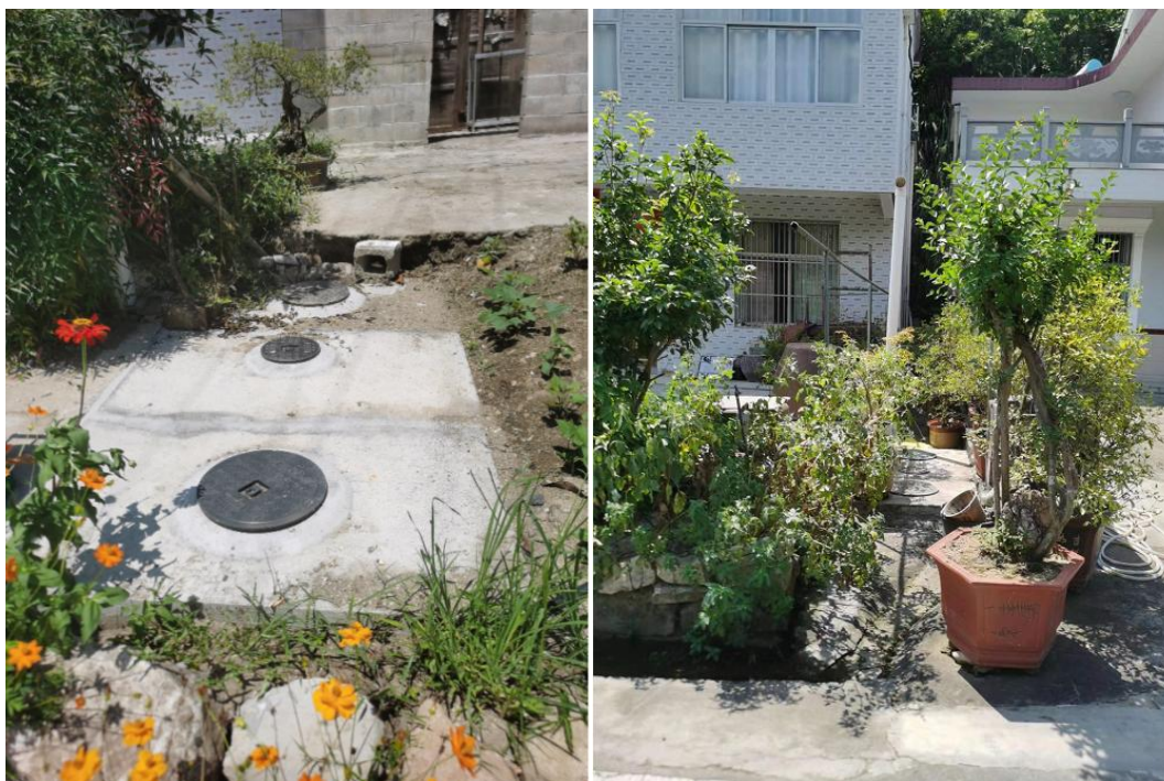
图 3.6-4 已建化粪池、部分化粪池出水进入边沟
