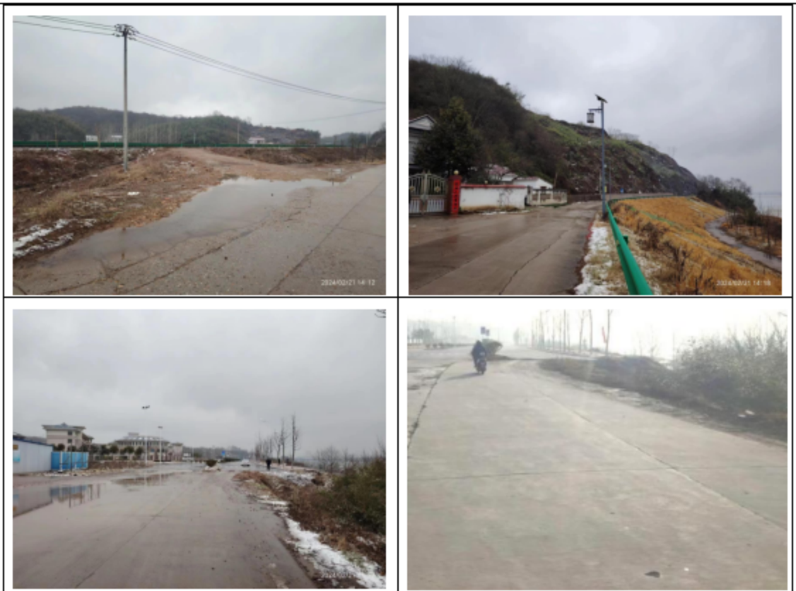
图 2-1 项目白改黑段路面现状
